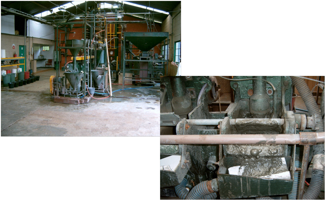
Figura 08: Equipamentos da planta piloto –vista geral
