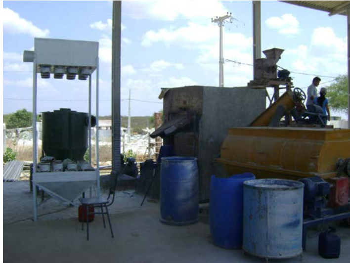
Figura 5-Mostra, à direita e acima, moinho de martelos, peneiramento no trommel enclausurado, transportador de rosca e um dos misturadores (tom amarelo); à esquerda o início da instalação dos filtros de manga.
