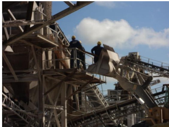
Figura 4. Manutenção na planta de beneficiamento com ato inseguro.
